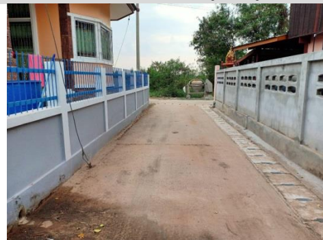
33. โครงการก่อสร้างรางระบายน้ำรูปตัวยู ซ. อุดมทรัพย์
