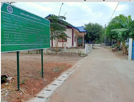
36. โครงการก่อสร้างรางระบายน้ำรูปตัวยู ซ. บำรุงศิลป์
