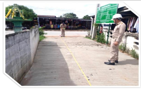
27. โครงการก่อสร้าง ถนน คสล. ซอย ปู่เฒ่า
