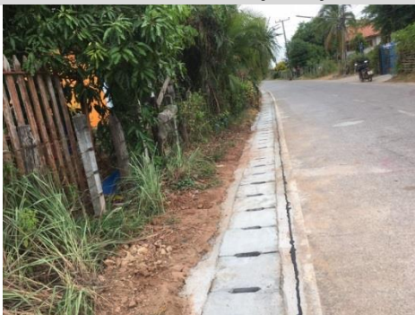
32. โครงการก่อสร้างรางระบายน้ำรูปตัวยู ถ.เทศบาล 3
